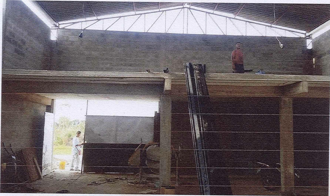
FOTO 04: Execução de sapatas, vigas baldrame, pilares, vigas aéreas e lage, sob minha responsabilidade.
